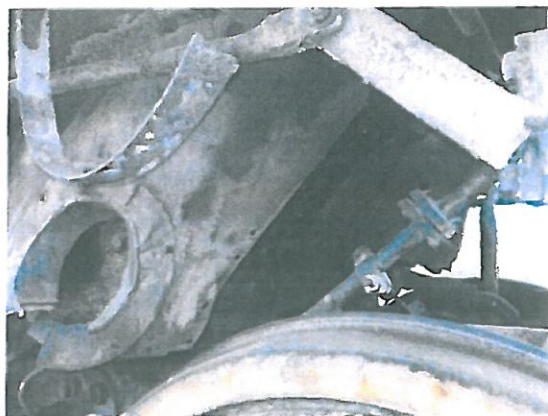
Zniszczona otulina na stojaku kotła z prawej strony
