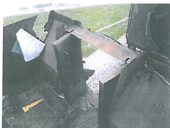
Pozostałe ściany skrzyni węglowej, zniszczenia przez korozję
